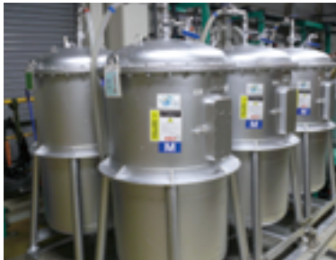
純水リサイクルシステムの一部
