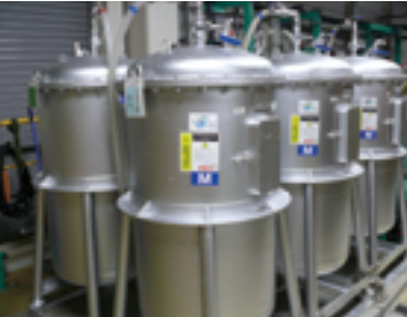
純水リサイクルシステムの一部
